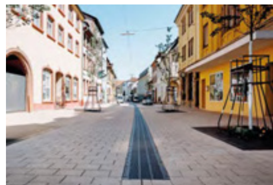
Die sanierte Königstraße in Landau: Regenwasser wird von den Verkehrsflächen in der Rinne gesammelt
